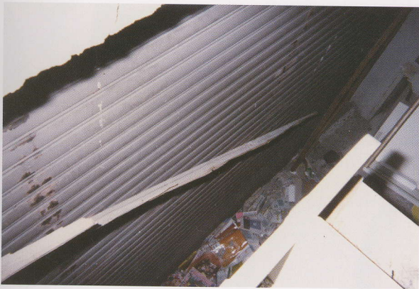
本が壁の隙間に落下。日東館そごう店は全壊
