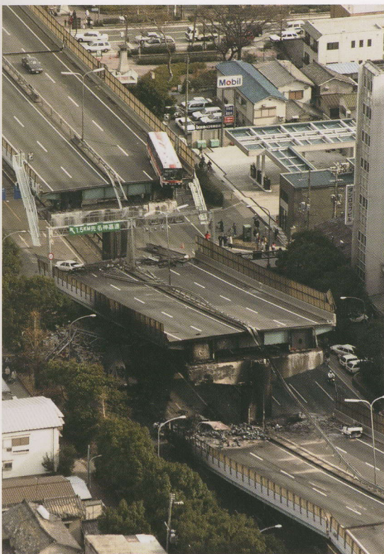
崩壊した阪神高速道路。間一髪、バスは転落をまぬがれた（1月18日）
